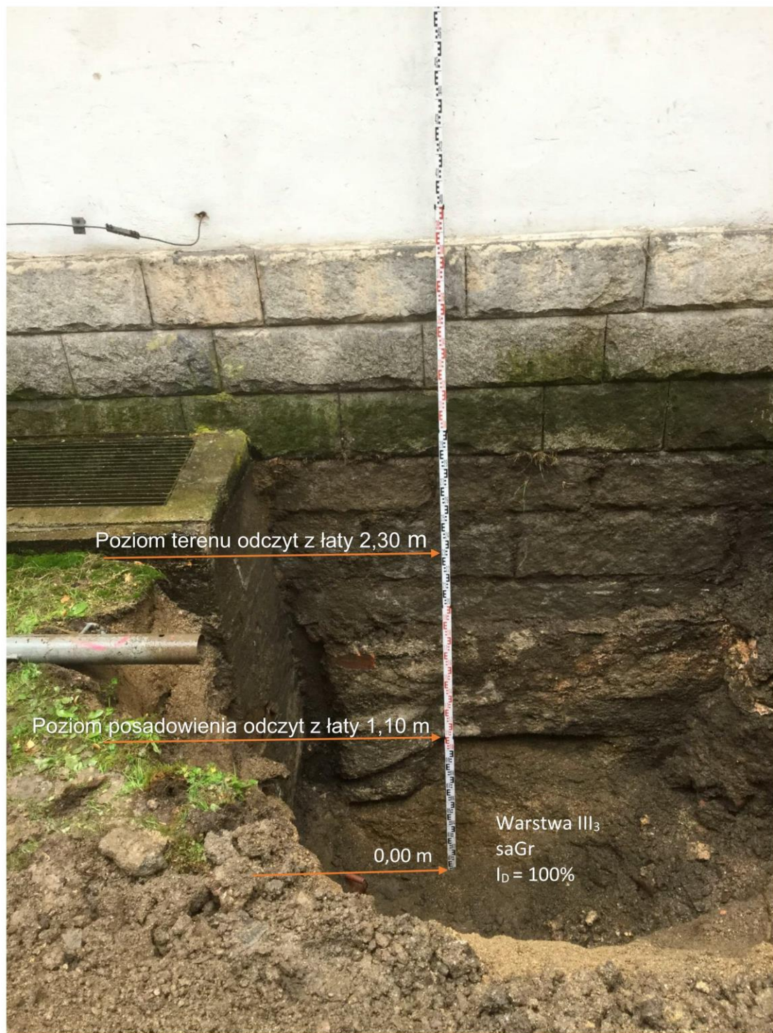
Zdjęcie nr 2. Odkrywka fundamentu. W podłożu zwietrzały granit saGR.
